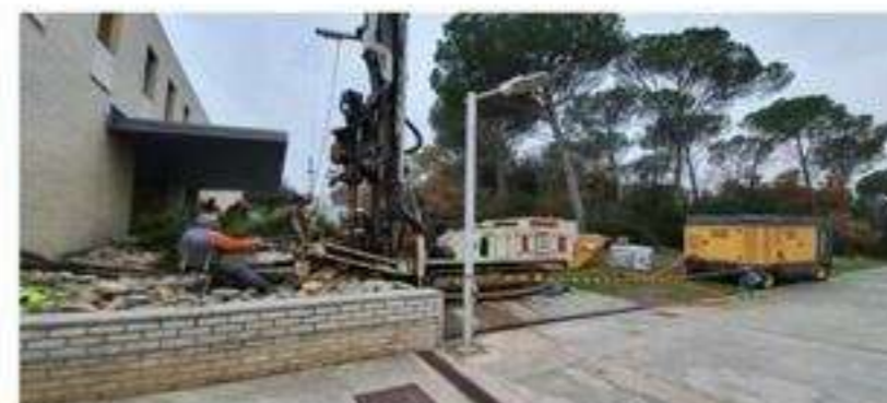
Escola Politècnica Superior de la Universitat de Girona Edifici PIV de l'Escola (9 kW)
