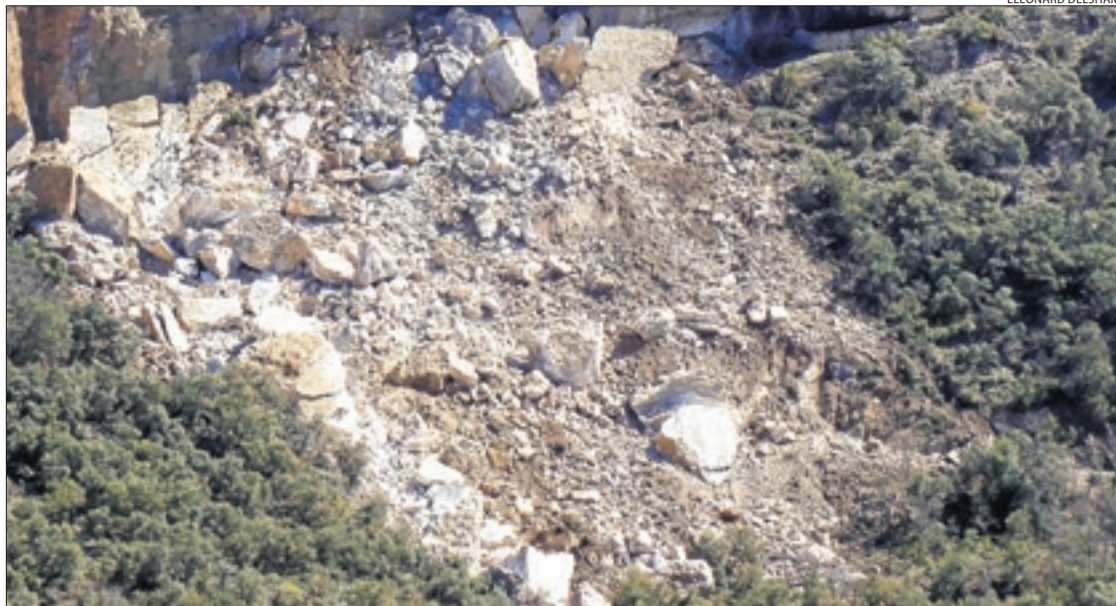
Imagen del desprendimiento de rocas sobre la LV-9124 en Castell de Mur.
