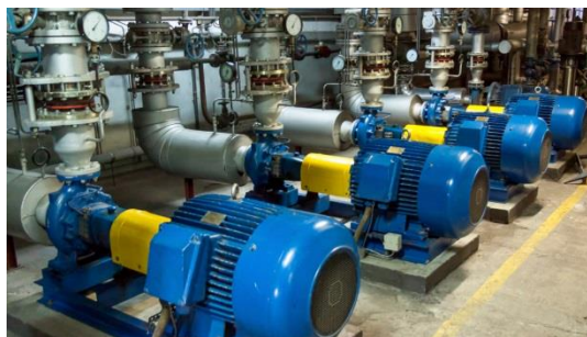
Estació bombament. Font: International Water Association
