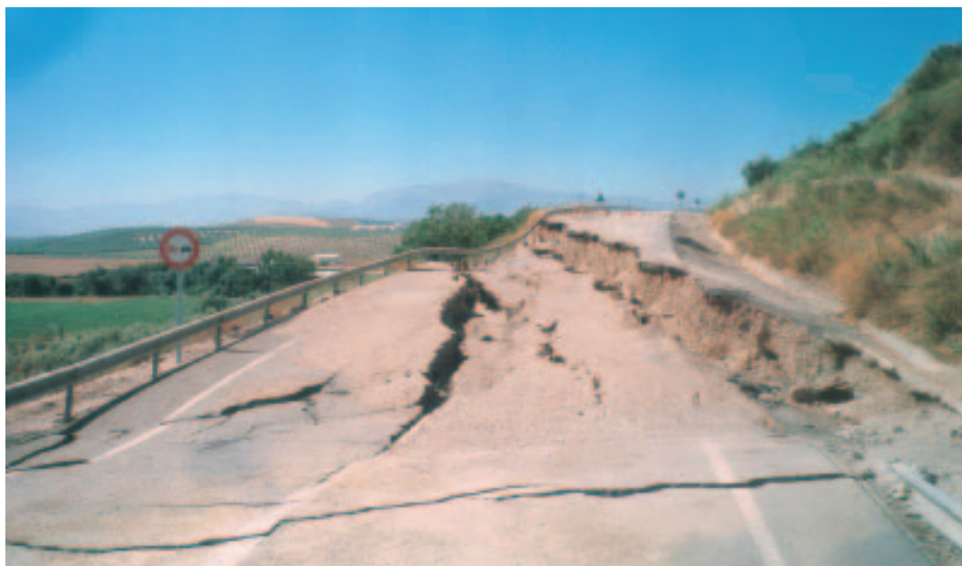
Moviment de vessant que afectà aquesta carretera comarcal del Pirineu de Lleida.
